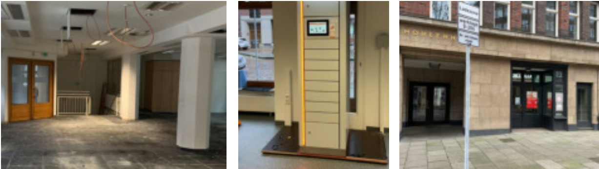
Abb. 26: Umbaumaßnahmen, Ladeschrank und Ladezone (Quelle: Hamburger Hochbahn)
